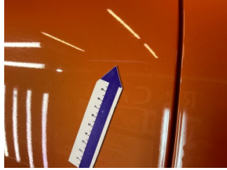
Kapı, sağ arka, Kapı, sağ arka > Çizik
